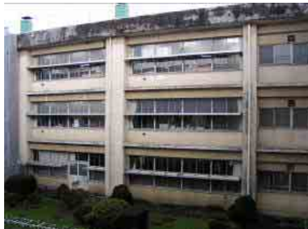
外装材の著しい劣化
