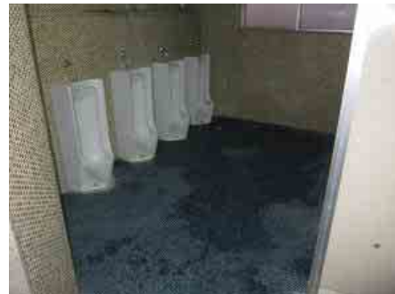
トイレの老朽化による臭気の発生
