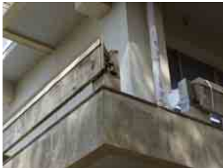
老朽化による手すりの落下
