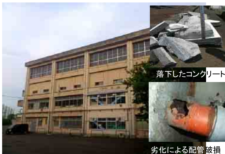
耐震化されたものの、老朽化による機能の劣化が著しい
