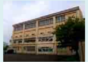
耐震化されたものの、老朽化による機能の劣化が著しい
