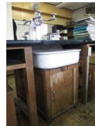
度重なる配管の破損
