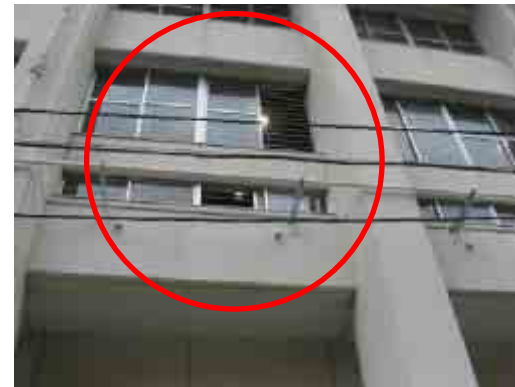
障子の落下箇所
