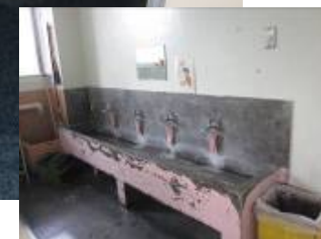
トイレの老朽化による臭気
