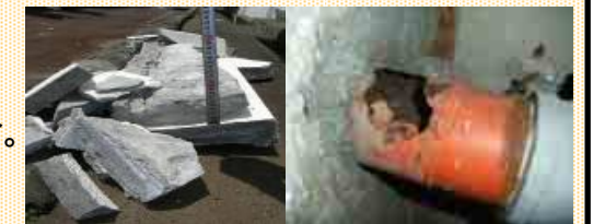
（左）落下したモルタル（右）劣化による配管破損
