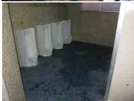
トイレの老朽化による臭気
