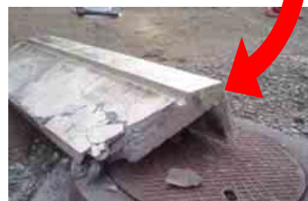
老朽化による手すりの落下
