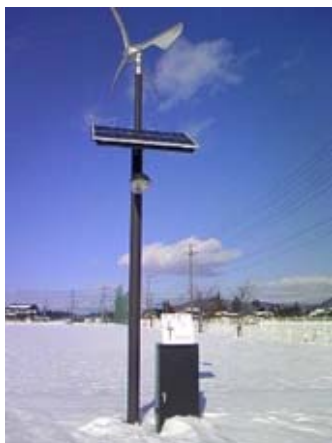
風力発電 (矢巾東小学校)
