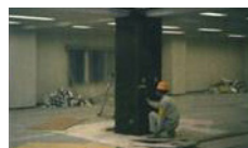
プライマー塗布 炭素繊維シートの付着強度確保のためにプライマーを塗布する。 （必要に応じ、パテ等で不陸修正を行う。）
