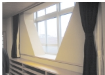
耐震補強ブレース
