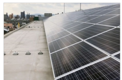
太陽光発電システム
