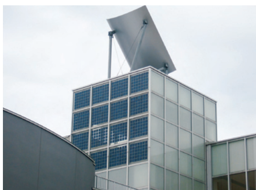
校舎壁面ガラスに1.4kWの太陽光パネルを設置 (富山県射水市立大門小学校)
