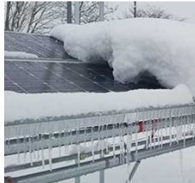
「CNTEC」を太陽光パネルの融雪に適用した例
